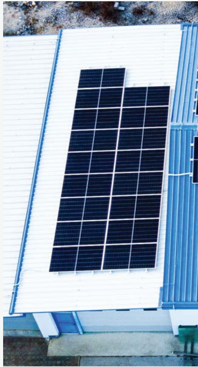
40 kW - SOLARNA ELEKTRANA, ŠIROKI BRIJEG
