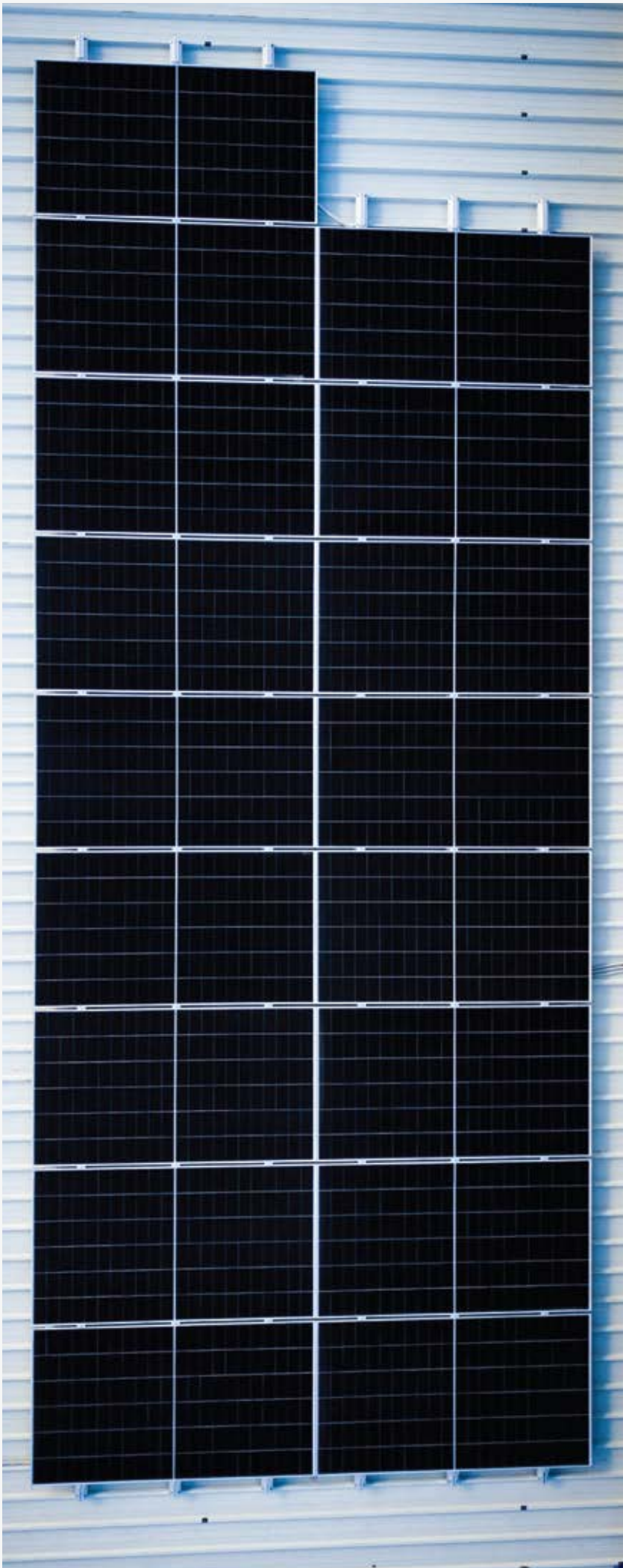
40 kW - SOLARNA ELEKTRANA, ŠIROKI BRIJEG
