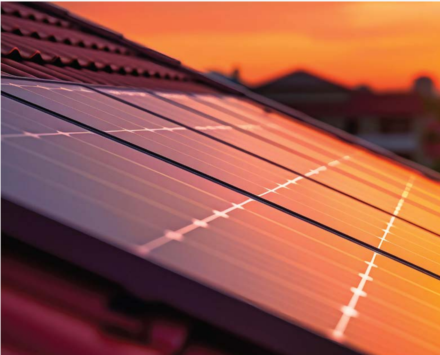
34 kW - SOLARNA ELEKTRANA, ZAGREB
