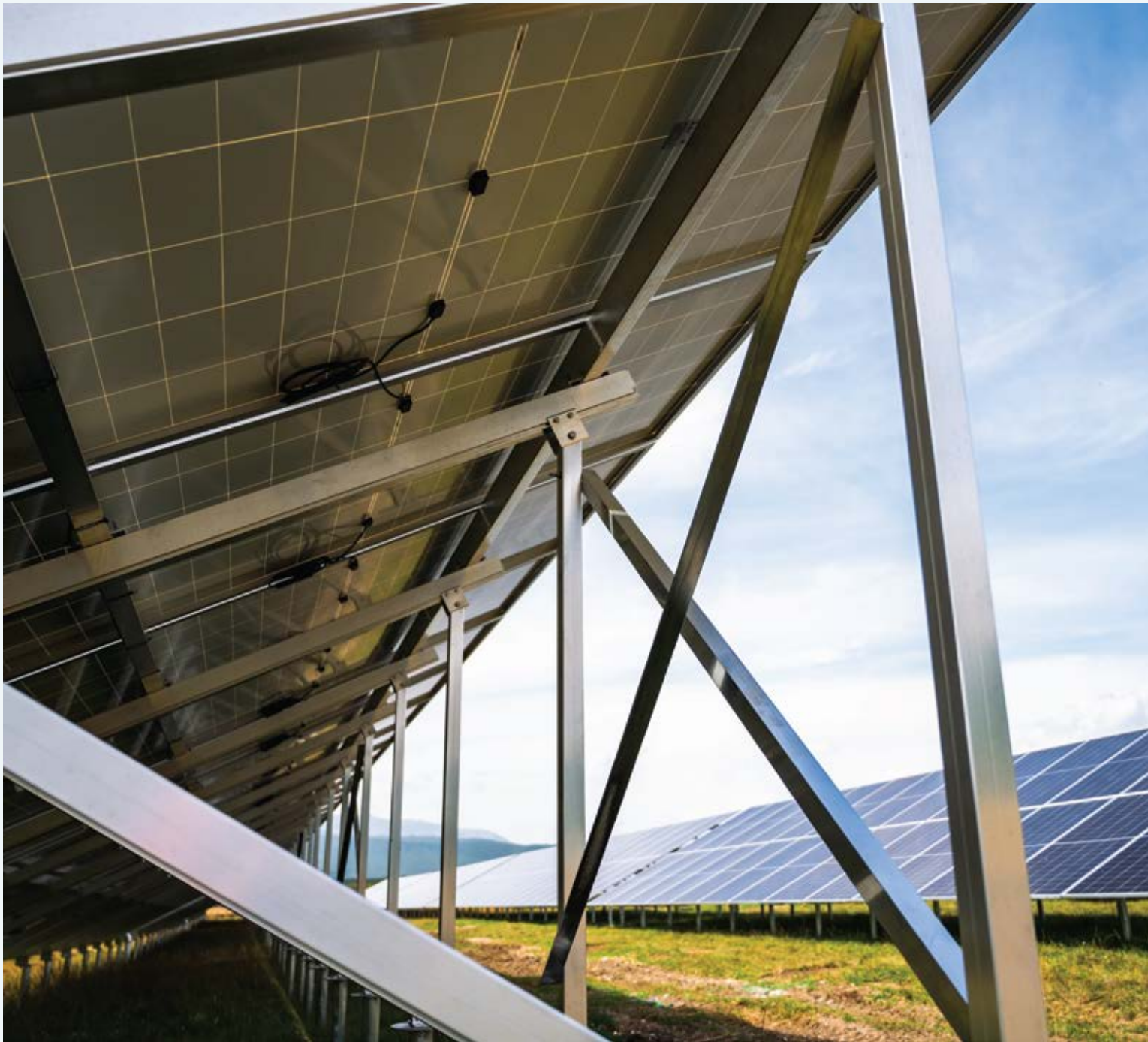
2 MW - SOLARNA ELEKTRANA, NEVESINJE
