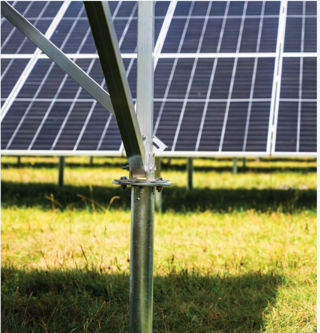
2 MW - SOLARNA ELEKTRANA, NEVESINJE
