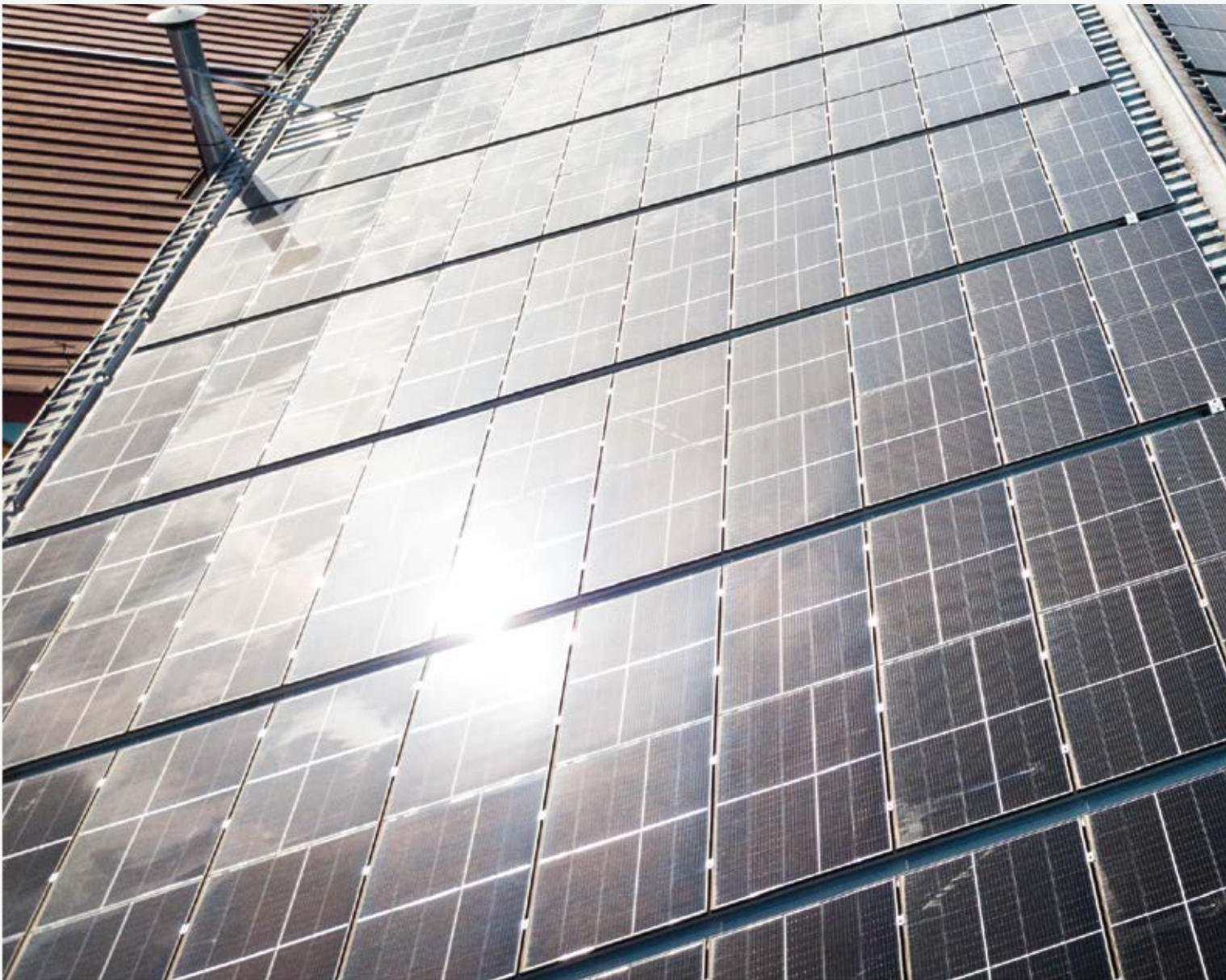
250 kW - SOLARNA ELEKTRANA, ŠIROKI BRIJEG
