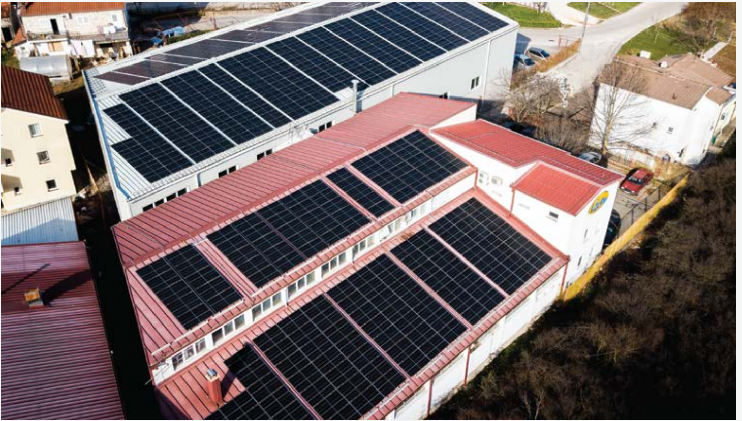
250 kW - SOLARNA ELEKTRANA, ŠIROKI BRIJEG
