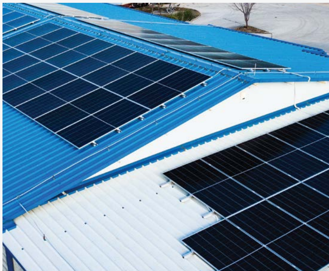
40 kW - SOLARNA ELEKTRANA, ŠIROKI BRIJEG
