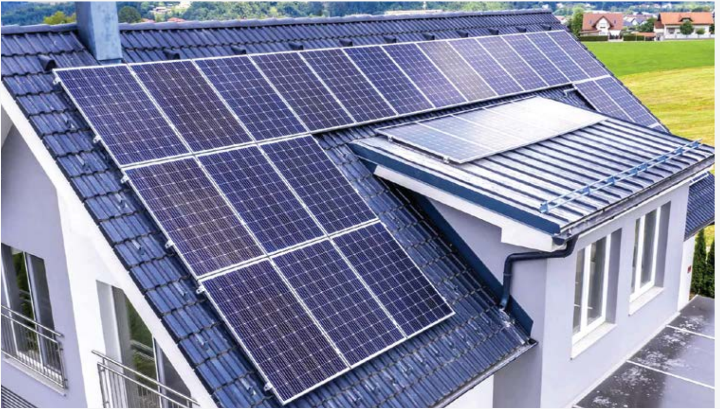
23 kW - SOLARNA ELEKTRANA, KUPRES
