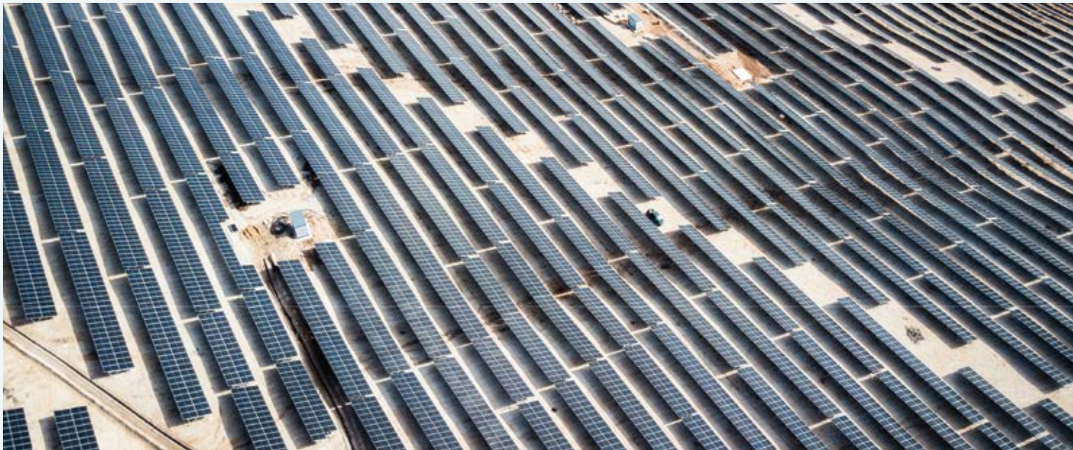
24 MW - SOLARNA ELEKTRANA, POLOG
